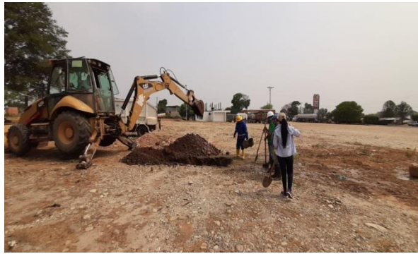
Foto: Mantenimiento de tubo por ruptura
